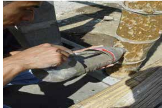
Figura 5. Relleno de canutos con cemento. Del Manual de construcción “Construir con bambú” (Morán Ubidia, 2015)
