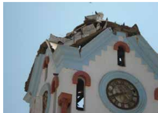
Figura 8. Fallas en los muros por corte
